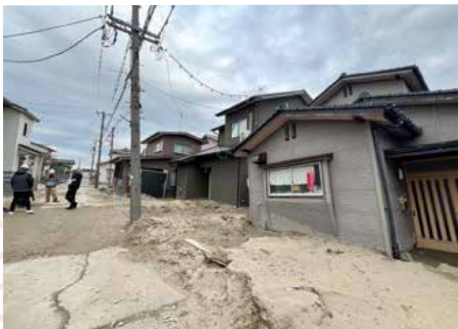
石川県内灘町の液状化現象
